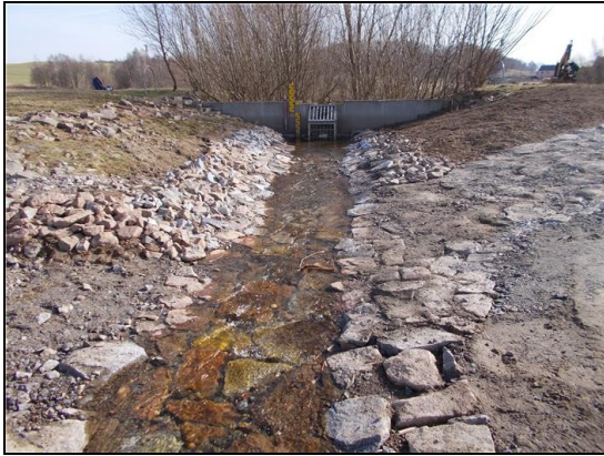
Abb. 4: nach der Maßnahme: Beräumte und neu ausgebaute Abschnitt vor Drosselbauwerk, Blick stromab, 04.04.2018
