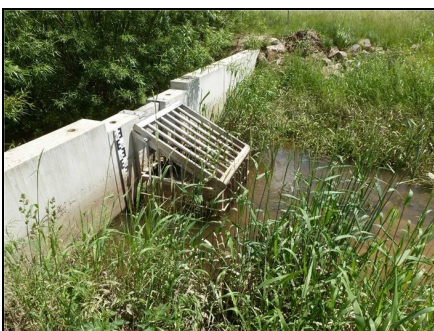
Abb. 1: vor der Maßnahme: Zugesetzter Ablauf Drosselbauwerk, 11.06.2013
